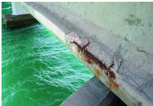
Рис. 2. Коррозия при контакте с водой
