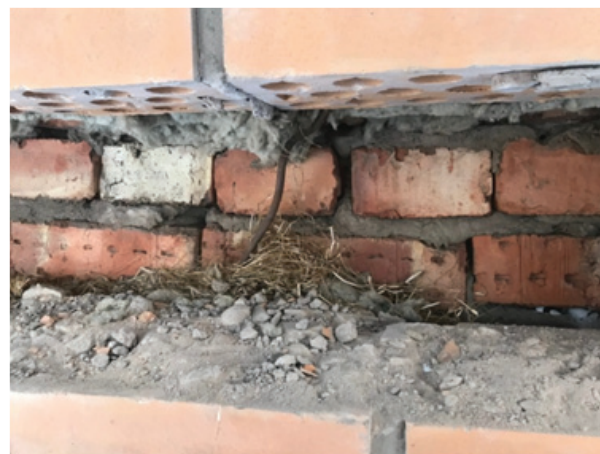
Рис. 3. Дефекты в основной кладке
