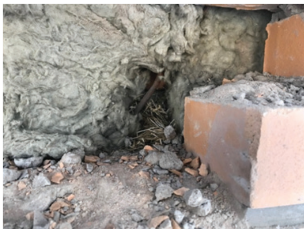
Рис. 2. Низкое качество теплоизолирующего слоя
