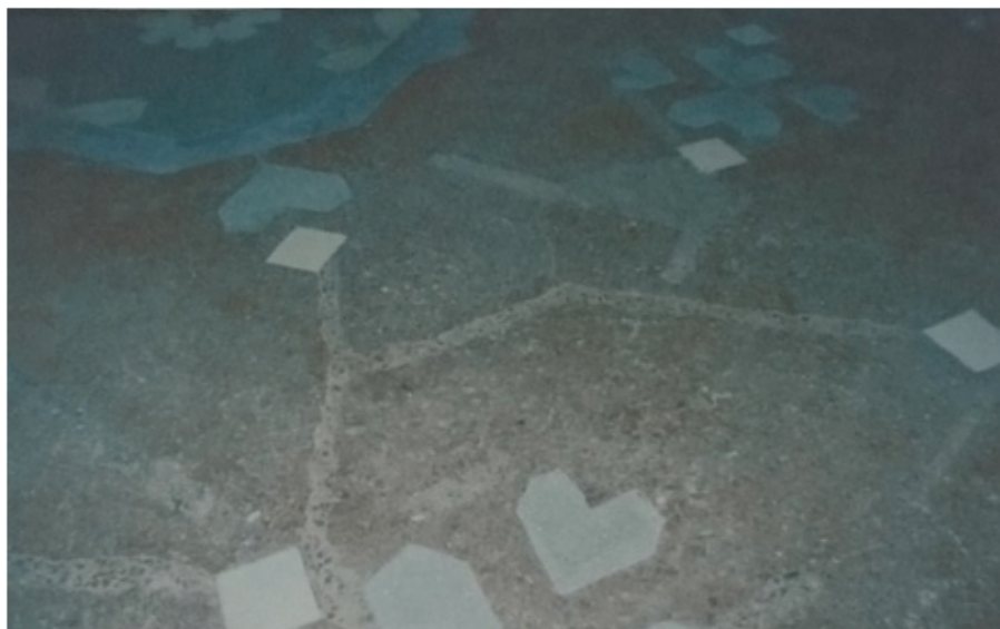
Рис. 4. Холодные швы, образовавшиеся при ремонте трещин в швах между существующим и новым растворами
