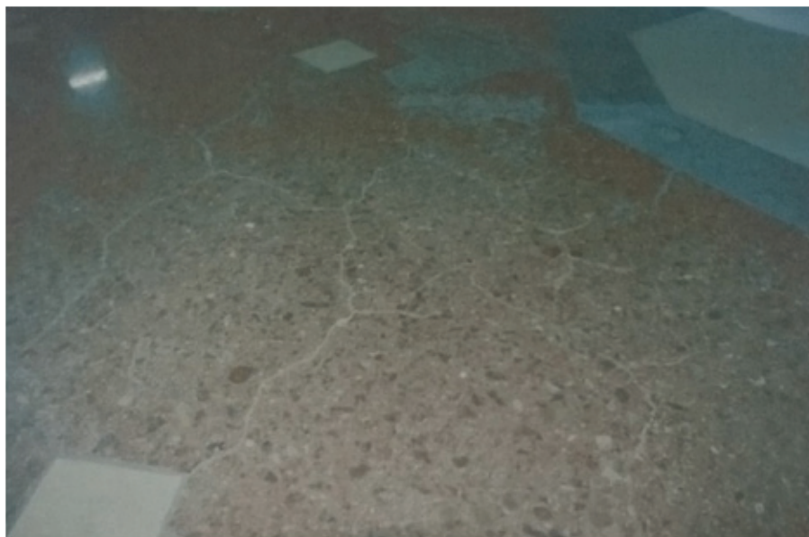
Рис. 1. Трещины шириной раскрытия до 0,1 мм усадочного характера от углов узоров (вставок)
