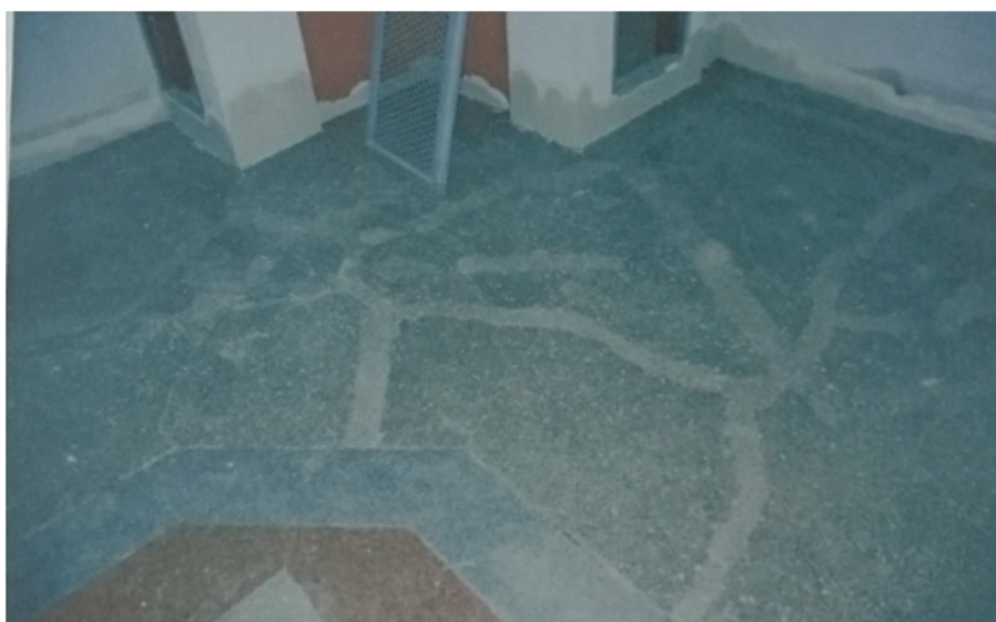
Рис. 5. Несоответствие оттенка полов на отремонтированных участках
