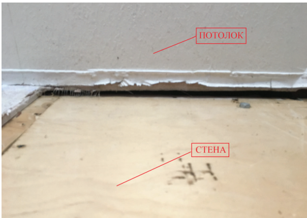
Рис. 6. Трещины на стыке стены и потолка на первом этаже дома
