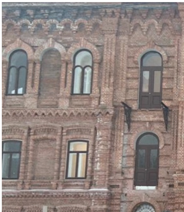
Рис. 1. Появление первых высолов (левая часть главного фасада)
