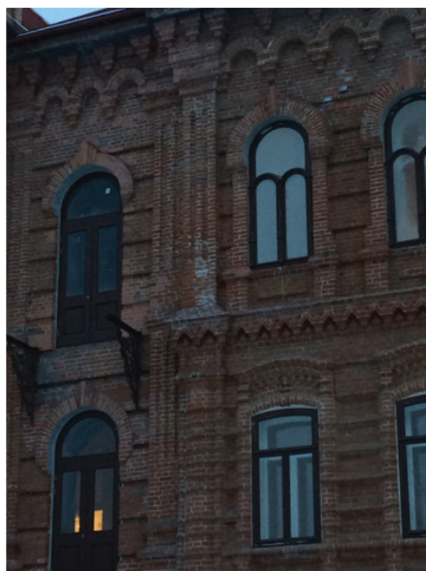
Рис. 4. Высолы на кирпичной стене (правая часть главного фасада)
