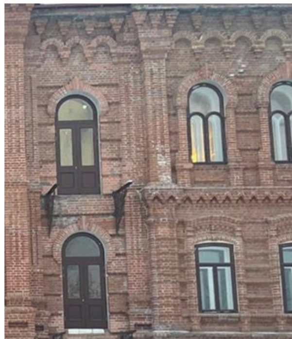
Рис. 2. Появление первых высолов (правая часть главного фасада)
