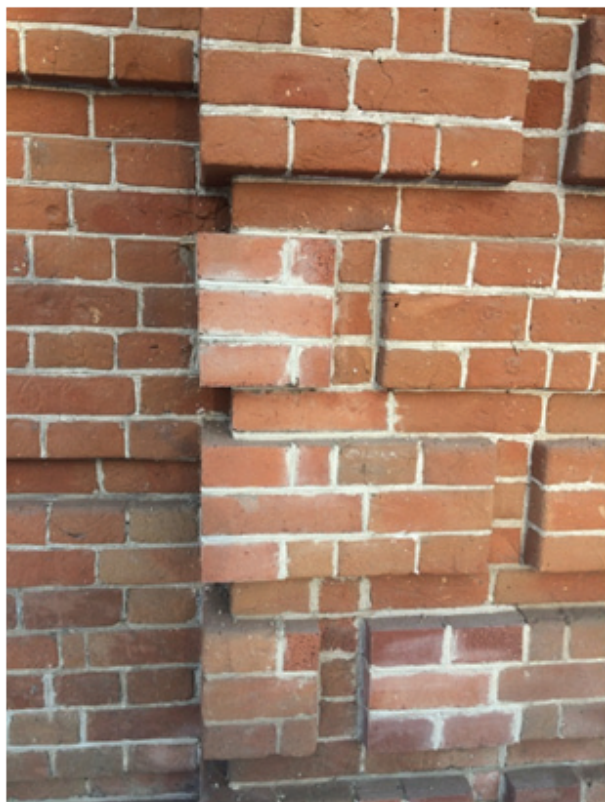
Рис. 5. Участок кладки с нарушением толщины шва, также видно попадание раствора на кирпич
