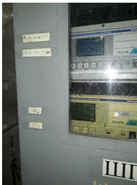
Рис. 1. Шкаф с контрольно-измерительной аппаратурой МАРК-409
