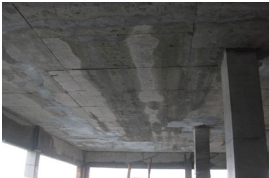
Рис. 1. «Замерзшие» бетонные участки перекрытия
