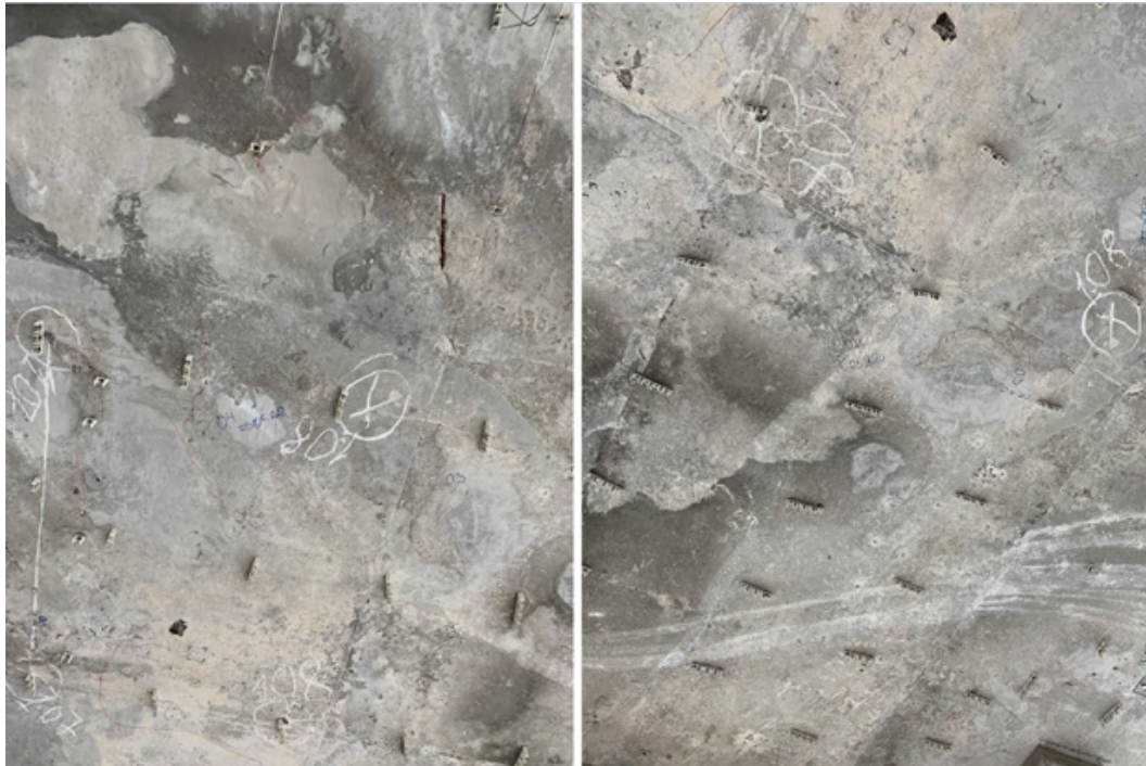
Рис. 1. Визуальные особенности промерзшего участка бетона
