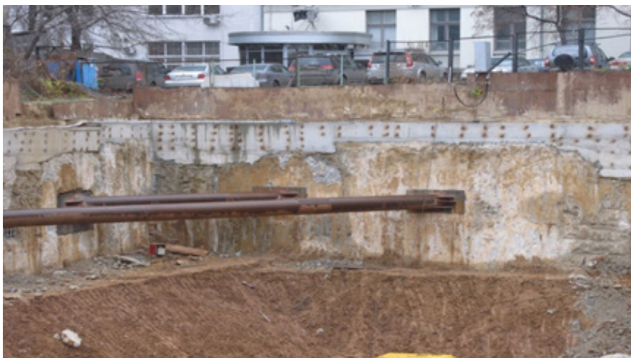
Рис. 1. Нарушения на объекте научно-технического сопровождения, приведшие к развитию аварийной ситуации
