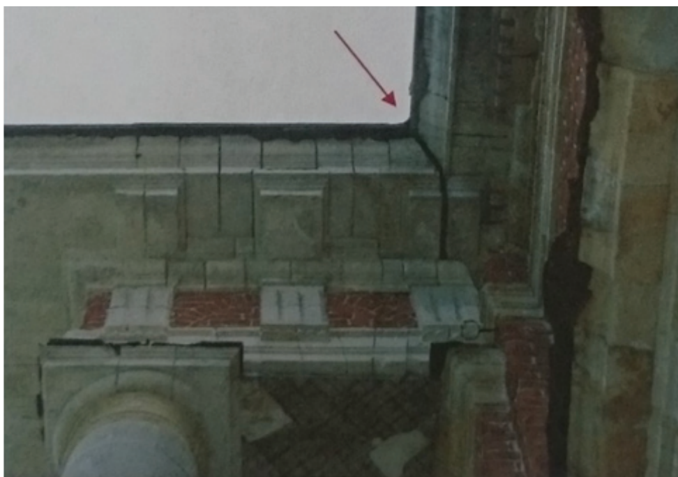
Рис. 8. Трещина шириной раскрытия 50 мм в месте примыкания конструкций карниза и фриза к стене здания
