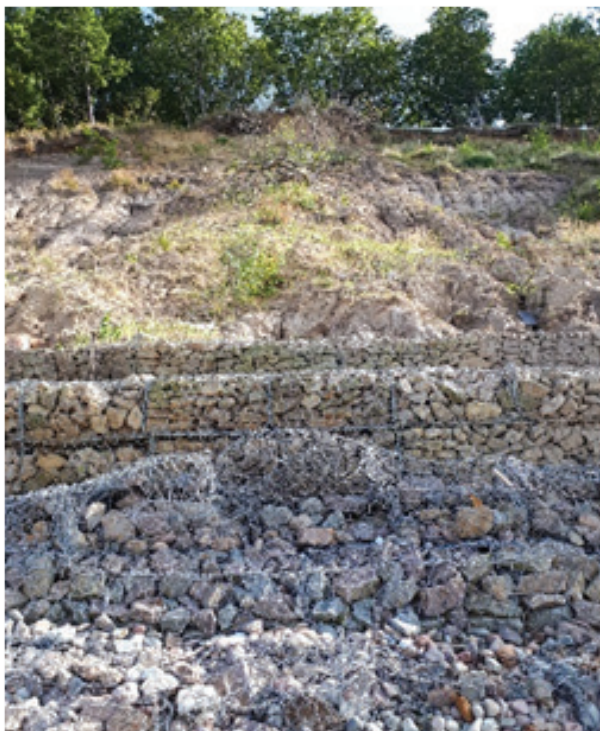
Рис. 3. Габрионная подпорная стена в полуразрушенном состоянии. Оползневой склон сохраняет устойчивость
