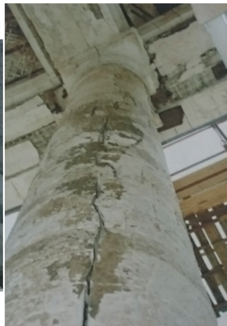
Рис. 3. Продольные трещины в кладке на всю высоту колонны
