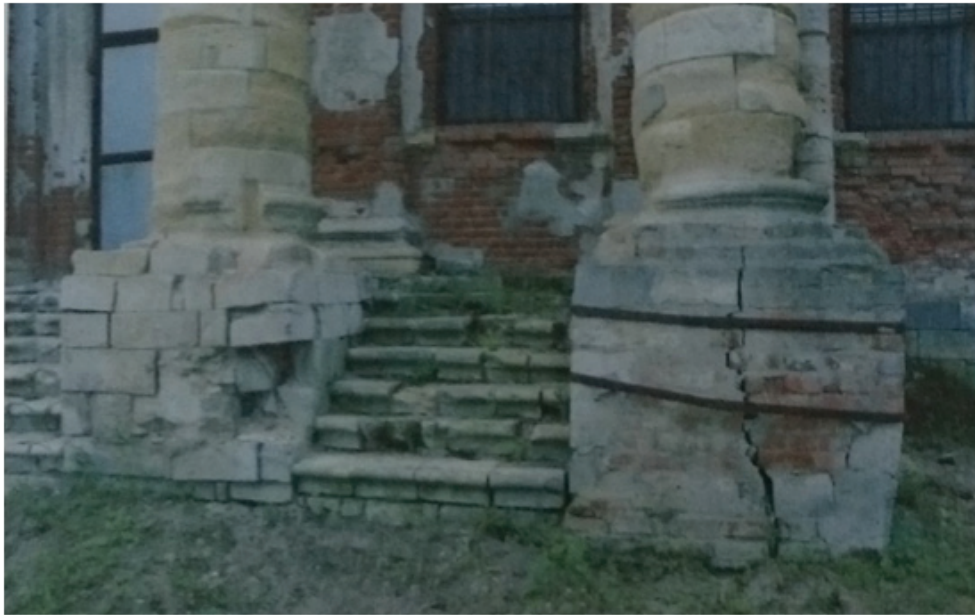
Рис. 1. Трещина шириной раскрытия до 40 мм в пьедестале колонны
