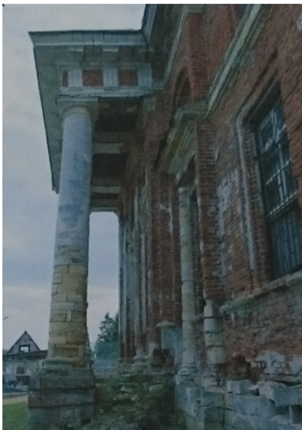
Рис. 4. Отклонение колонны от вертикали из-за неравномерных осадок фундамента
