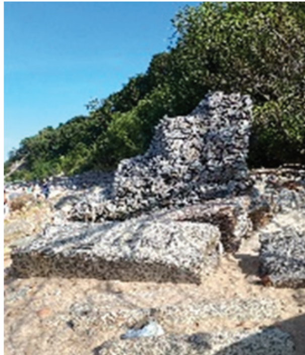
Рис. 2. Недостроенная стена. Обратная засыпка не выполнена. Под воздействием волн разрушены нижние ступени
