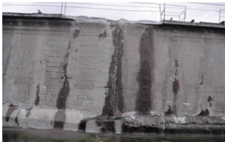
Рис. 1. Дефекты железобетонного резервуара
