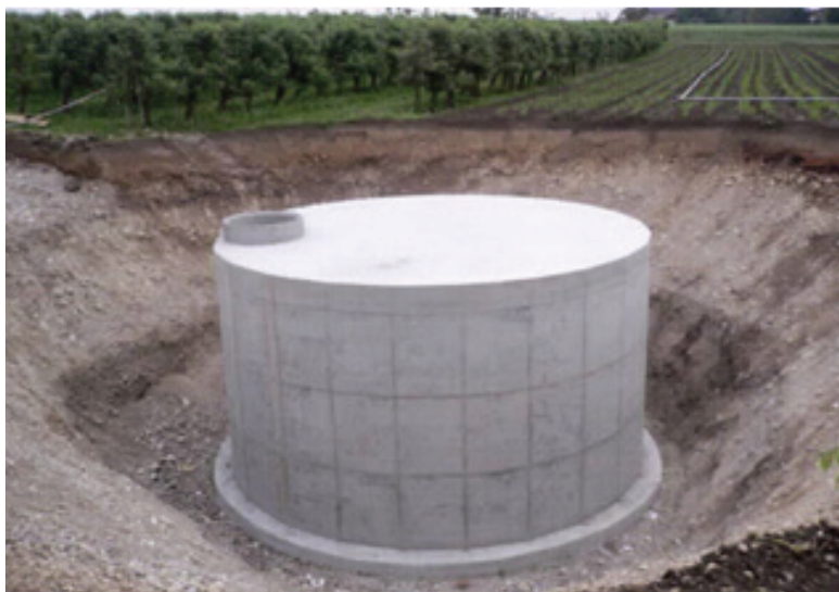
Рис. 1. Железобетонный резервуар противопожарного запаса воды
