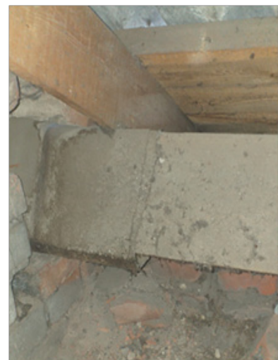
Рис. 8. Из-за неудовлетворительного ремонта кровли выявлены многочисленные следы намокания стропильных элементов
