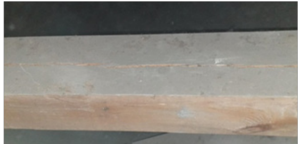
Рис. 5. Трещина в раскосе глубиной 32 мм
