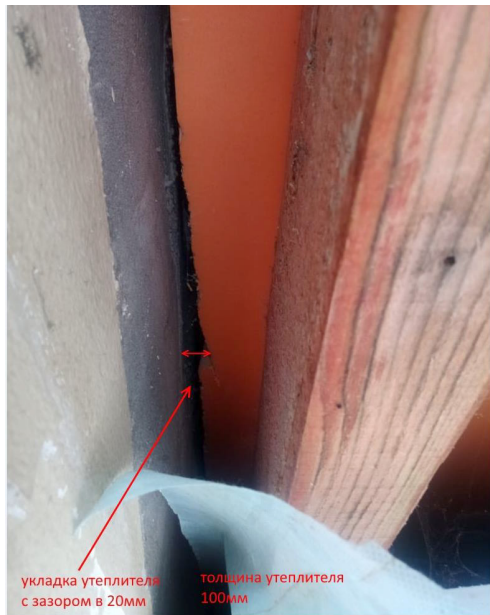
Рис. 10. Зазор между утеплителем и стеной
