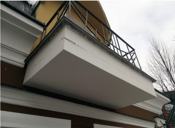
Рис. 1. Деструкция штукатурного и декоративно-отделочного слоев
