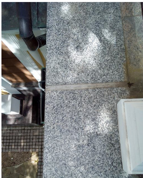
Рис. 6. Отслоение керамических плит от цементно-песчаной стяжки
