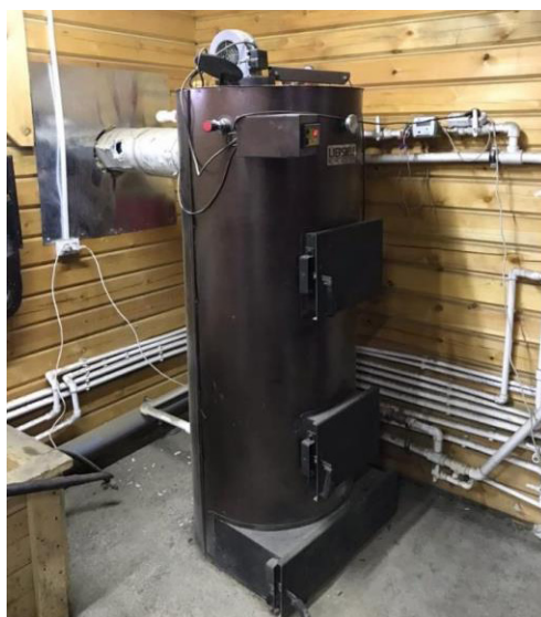
Рис. 1. Котел длительного горения Liepsnele Arctic 40U , расположенный в частном доме г. Якутска
