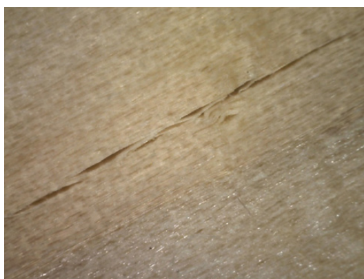
Рис. 1. Микротрещины после первого цикла увлажнения
